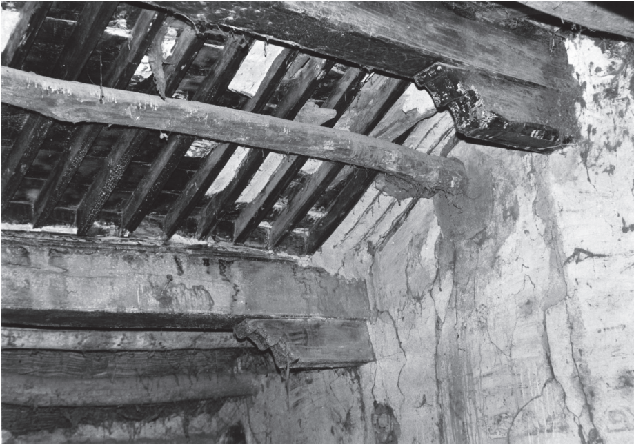
Deterioro de la techumbre antes de su desmonte.
