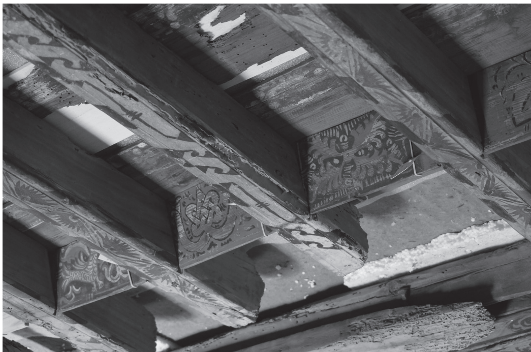
Detalle del montaje de la techumbre en los trabajos de su restauración.
