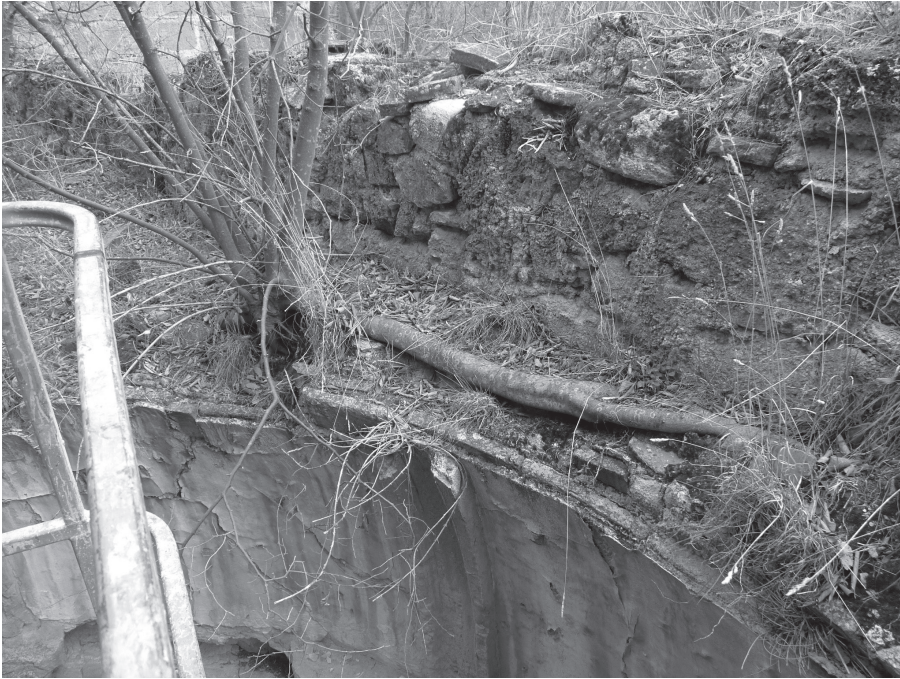
Estado de los restos de las bóvedas del templo colonizadas por la vegetación, 2014 (Belén Gómez Navarro).
