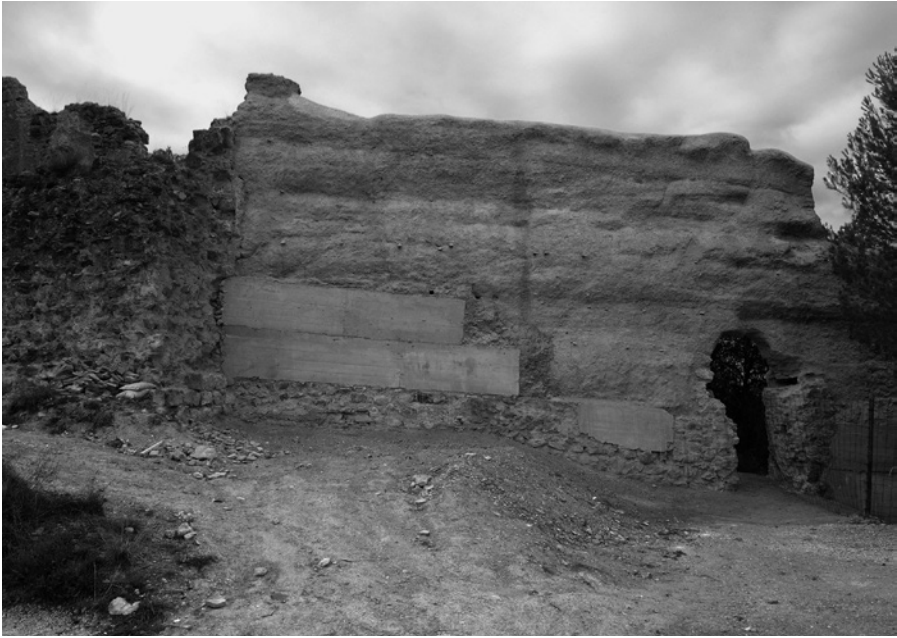
Consolidación de restos ruinosos con boquetes e importantes pérdidas de volumen sobre el zócalo de mampostería realizado siguiendo las improntas conservadas de las hiladas de las tapiadas (Foto: José María Sanz).
