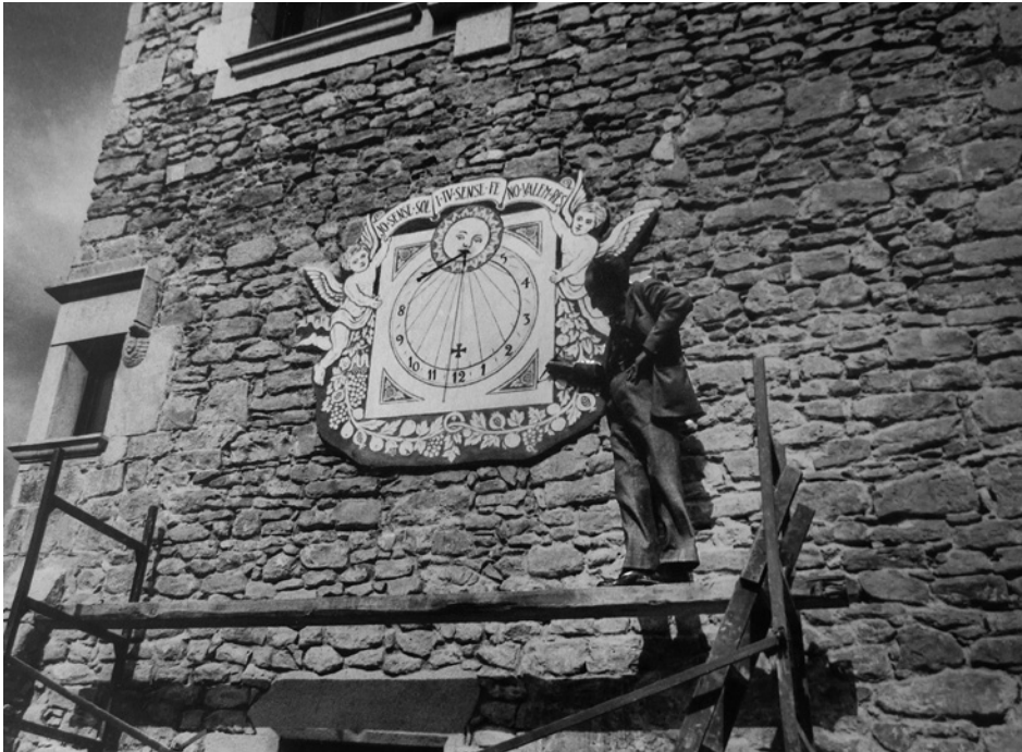
Ferran Serra subido al precario andamio y realizando un reloj de sol (Foto: autor desconocido).
