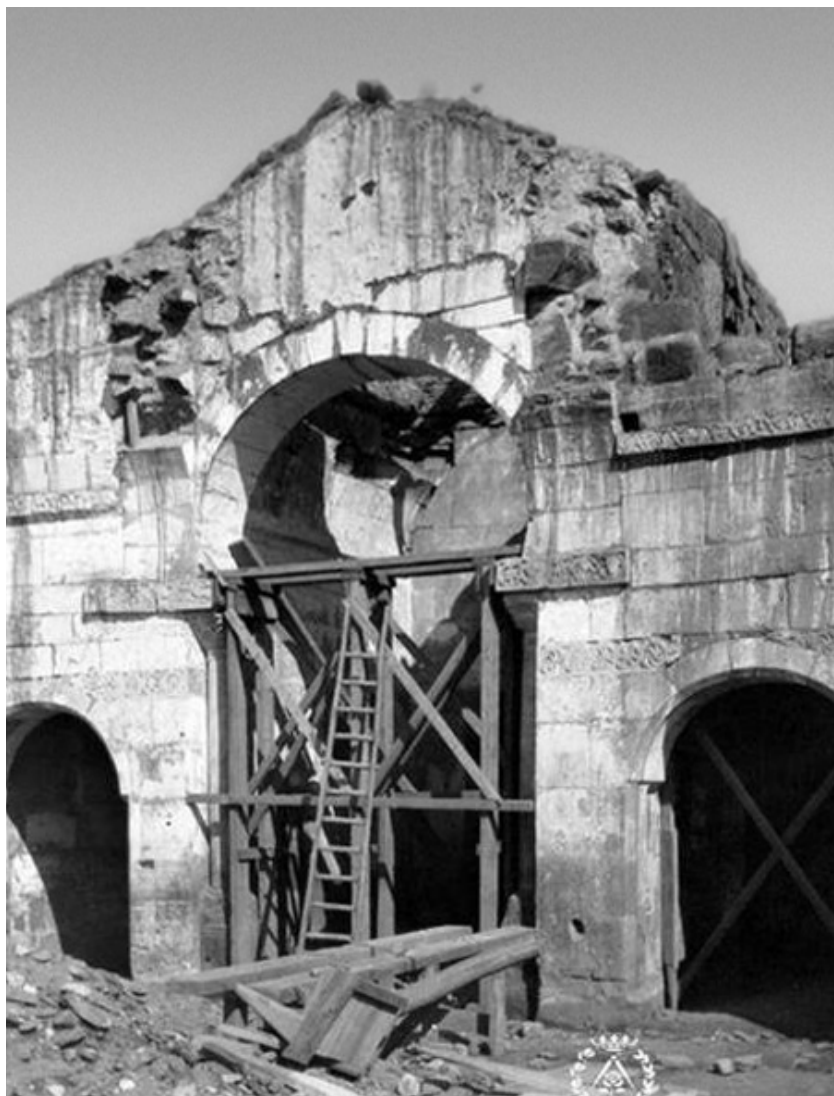
Fase de desmontaje del crucero de la iglesia (Foto: Archivo Colegio de Arquitecto de Lleida, signatura 414-1119).
