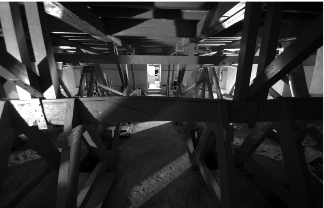
Estado inicial de la viga que sustenta la primera fila de contrapesos, completamente deformada y con roturas debidas a la flexión (M. Landa).
