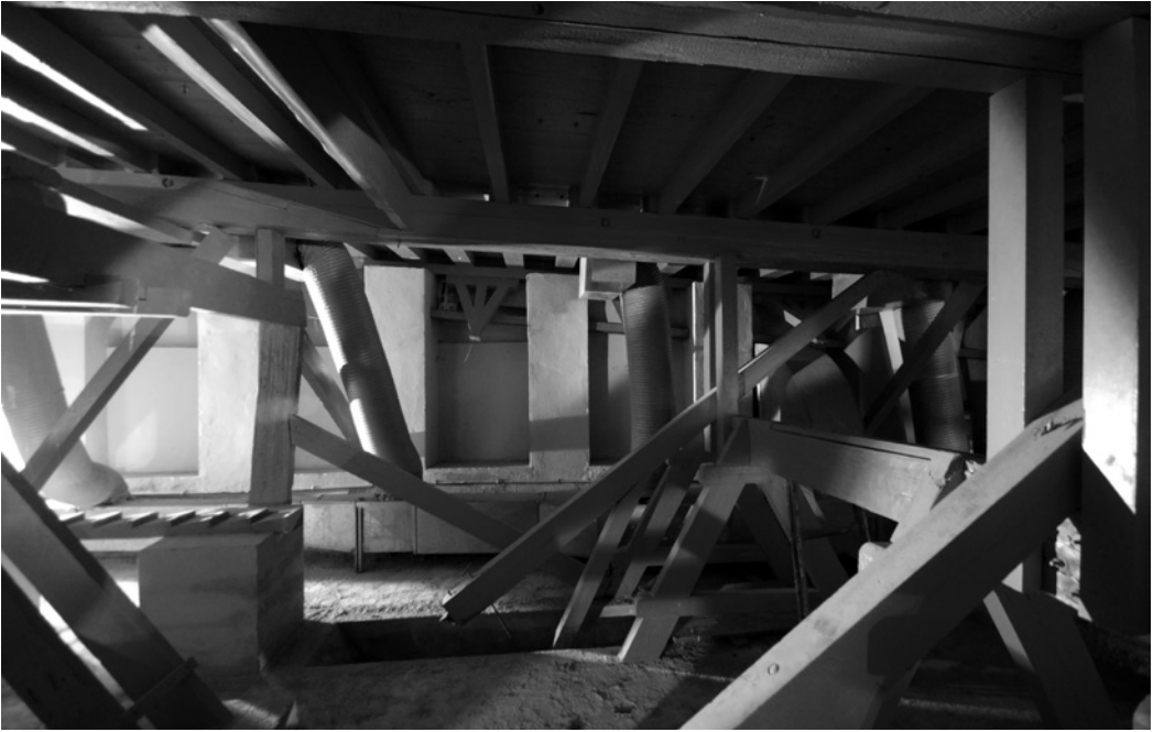
Estado de la estructura del mecanismo previo la intervención. Se observan los desplomes de varias piezas y las lanzas de los contrapesos incompletas (M. Landa).
