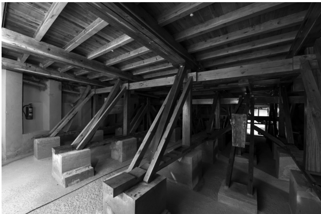
Imagen del tercer pórtico de pilares móviles, sustituidos los originales de pino por piezas de elondo, y duplicados los tornapuntas a cada lado de los pilares (M. Landa).
