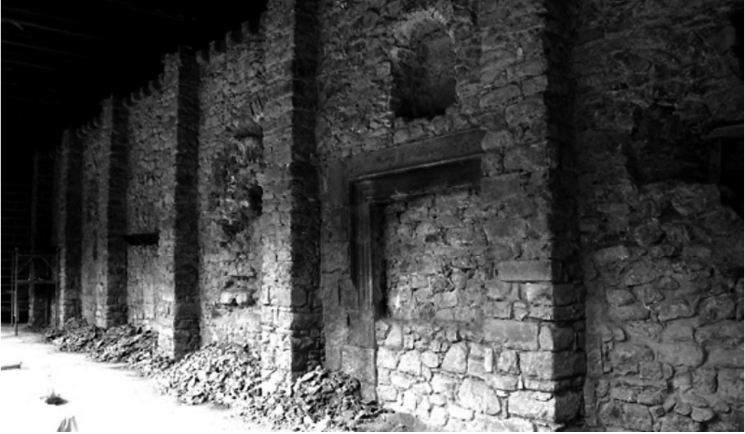
Durante el proceso de repicado del revestimiento de los muros, iban apareciendo los restos de las aberturas históricas (E. Colls).
