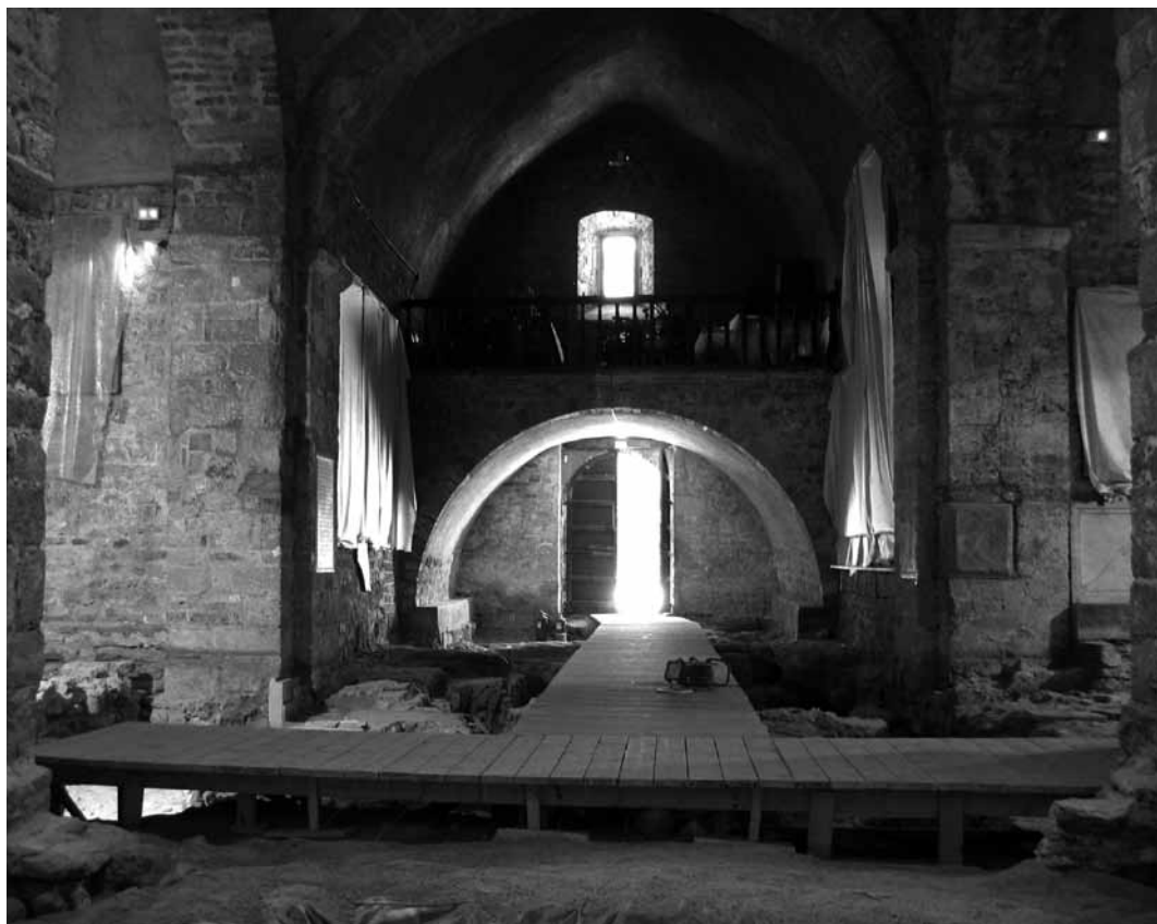
Figura 6. Santa María de Terrassa. Aspecto de la nave, el coro al fondo, antes de la restauración.
