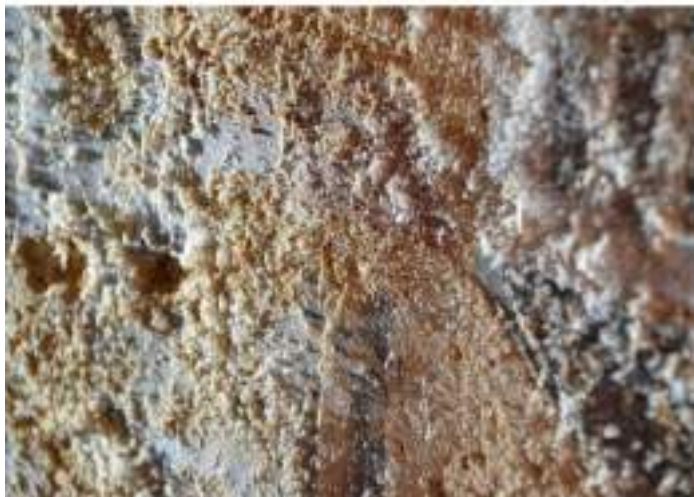
Estado del zócalo de la nave por efecto de las humedades de capilaridad.
