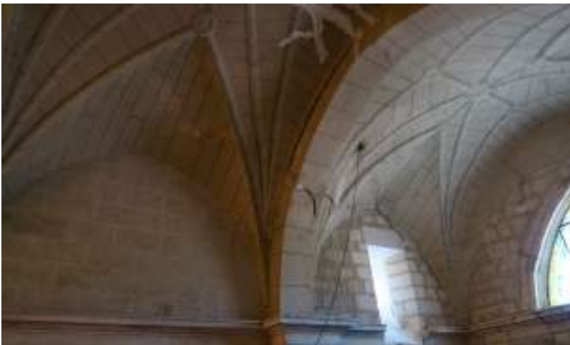
Vista de la patología en los dos últimos tramos de la nave.
