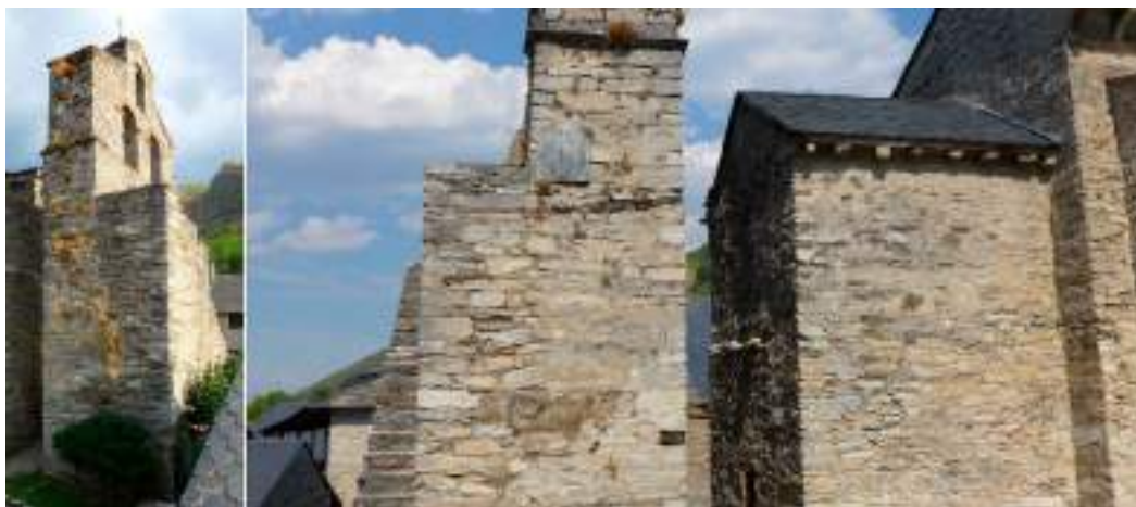
Figura 8. La torre de Peñalba después de la intervención de Menéndez Pidal. Se observa el añadido en su respaldo (izqda.). También se distinguen unas lajas salientes por encima de la capilla de San Genadio, restos de la repisa que sostenía el acceso al cobertizo de campanas (dcha.)
