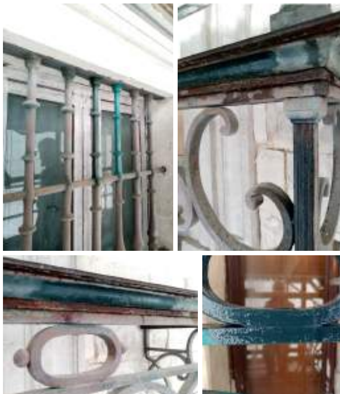
Figura 12. Detalles de pruebas de policromía realizadas en la rejería del Palacio de Santa Cruz en Valladolid. En la fotografía superior derecha e inferior izquierda vemos el tratamiento original imitando el cardenillo, en seco y también mojado para controlar el brillo y la intensidad de la policromía. Enorme cambio de cualidad del brillo según el número de manos aplicadas.
