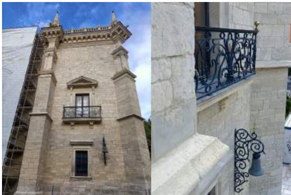
Figura 14. Fachada del Palacio de Santa Cruz, restauración de uno de los paños, salvo la parte inferior. A la derecha, detalle de balcón y campana del paramento restaurado.
