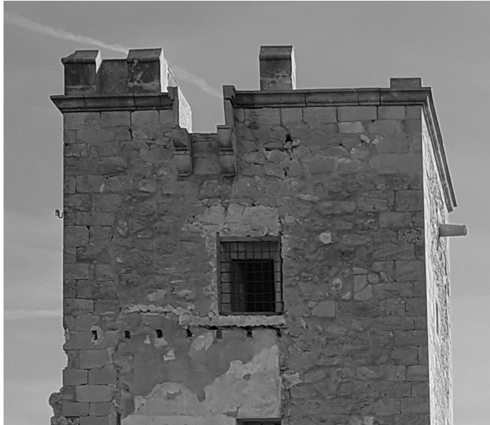
Detalle del remate superior del alzado norte de la torre (Elisa Moliner Cantos, 2019).
