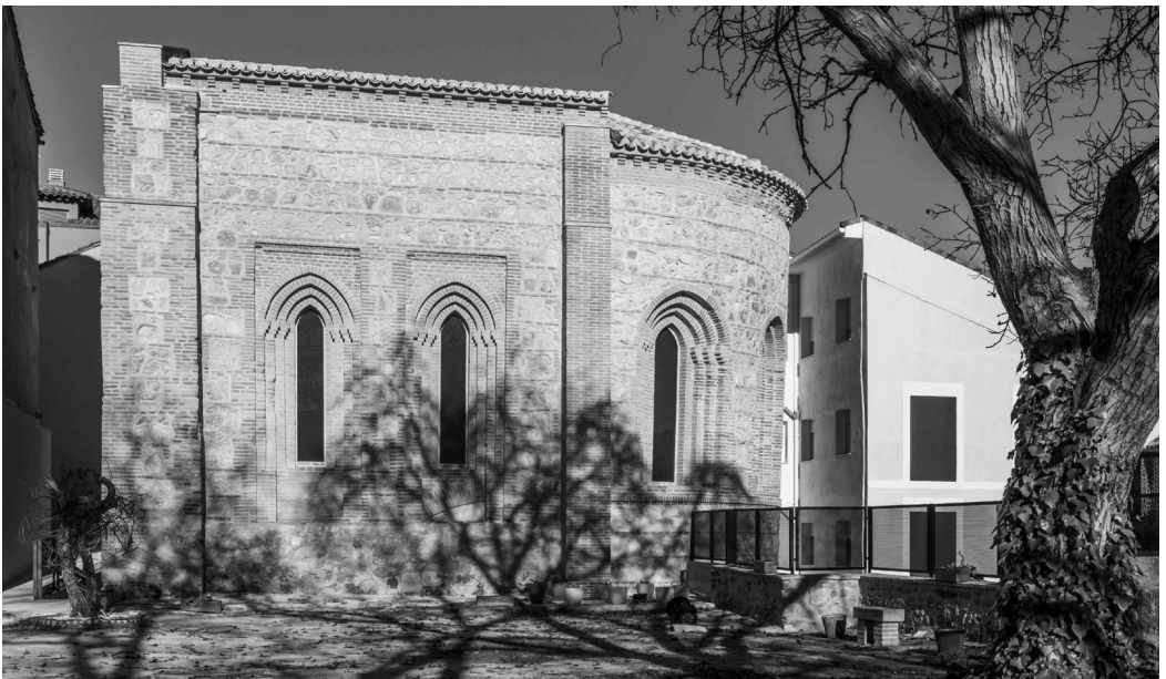
Fachada lateral del lado de la epístola al finalizar los trabajos. S (Joaquín Zamora Muñoz).
