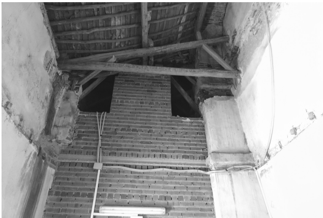
Figura 5. Aspecto que ofrecía una de las estancias del atrio, después de la reforma que tuguizó esta parte de la iglesia.
