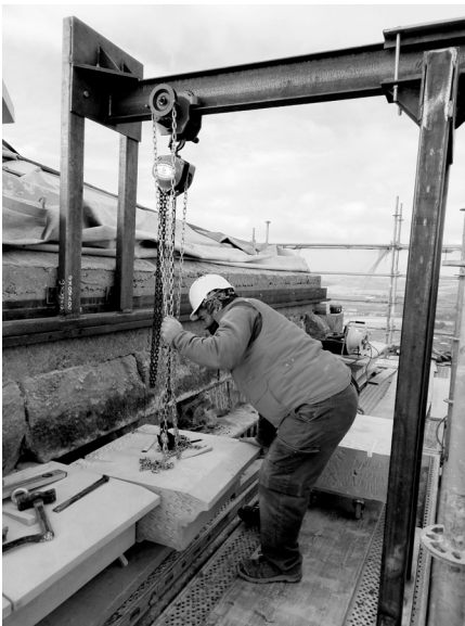
Medios auxiliares empleados para la colocación de las nuevas piezas de la hilada superior de la cornisa de coronación.
