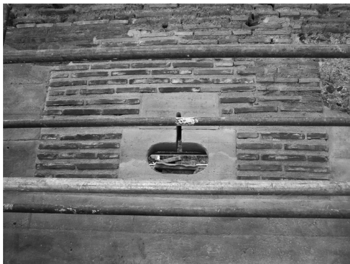
Tronera 5 reconstruida. El agua sigue saliendo por debajo de la tronera, a través de una tubería oculta dentro del muro rehecho.
