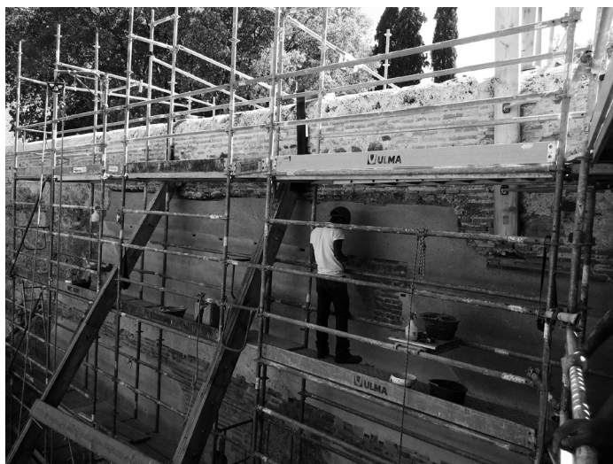
El muro se está completando hasta llegar a la base del pretil.
