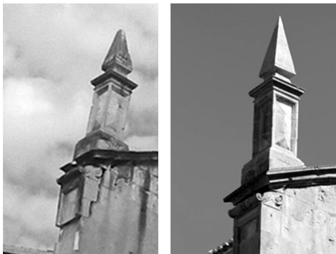
Estado tras los terremotos (izquierda) y final (derecha), de uno de los pináculos de la ex colegiata de San Patricio en Lorca, una vez reparado el fallo por deslizamiento de su base y completadas las piezas faltantes, así como el fijado con varillas de fibra de vidrio al soporte.
