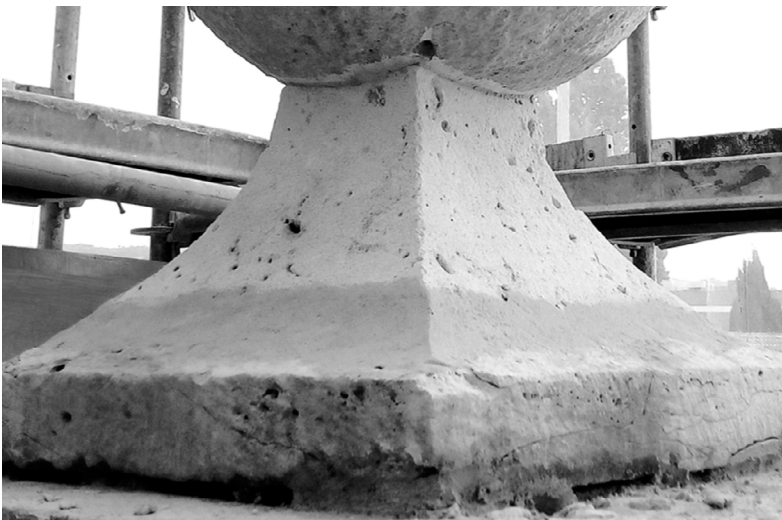
Figura 6b. Sustitución del apuntalamiento por una nueva pieza de caliza ensartada mediante una barra de acero inoxidable en la esfera y en el pedestal.
