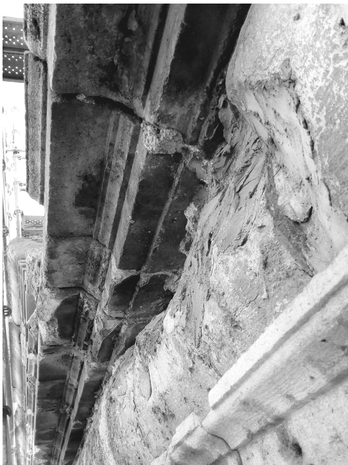
Figura 7. Pérdidas de piedra, rellenos y parches de cemento, biocolonias y costra negra bajo una de las cornisas de la cara norte de la espadaña.
