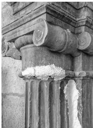
Figura 14. Supresión con papetas de celulosa de la costra negra existente sobre las pátinas de la portada.
