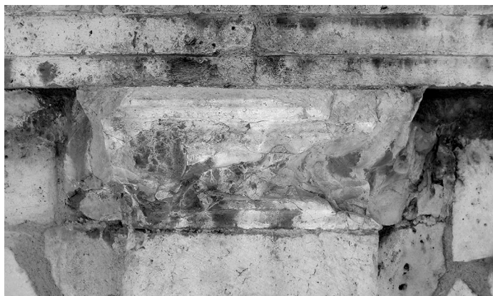
Figura 11a. Capitel dañado por la estructura de la caseta de campanas.
