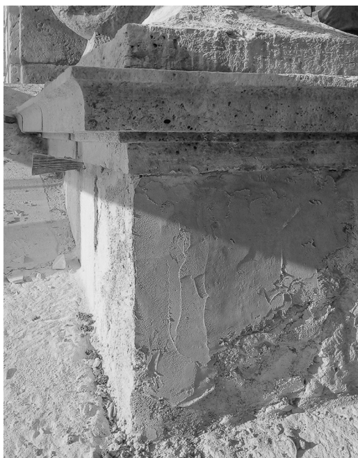
Figura 10. Reconstrucción volumétrica con morteros de restauración con base de cal, de la cara sur del pedestal oriental de la espadaña.
