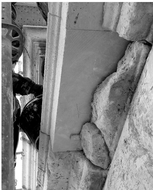
Figura 9. Reconstrucción selectiva con cantería de piedra de Colmenar, de los sectores más dañados en las cornisas de la cara sur de la espadaña.
