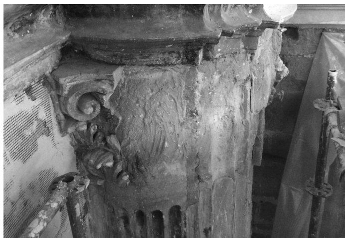
Capitel de la Capilla de la Inmaculada. Estado inicial antes de la intervención de 2020.
