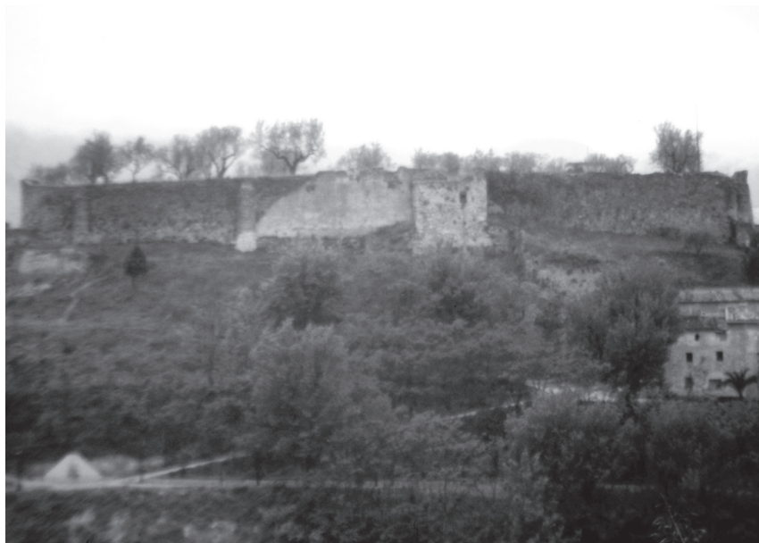
Muralla del lado norte, estado anterior al colapso. (S. Varela Botella).
