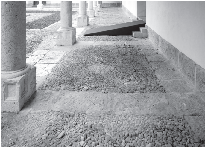
Figura 10. Rampa provisional y estado de los solados de las galerías, 2016 (J. L. Quintana Gordon).
