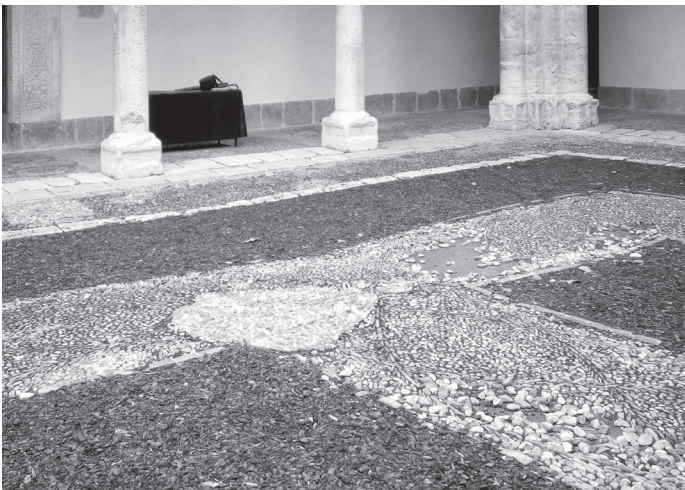
Figura 11. Mal estado de los solados con base de tierra aglomerada con morteros de cal en el espacio central del patio, 2016 (J. L. Quintana Gordon).
