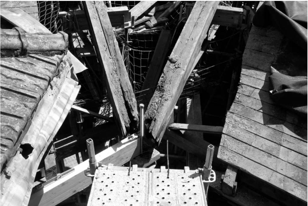
Un ejemplo de los daños causados por el agua y estado de las vigas principales de la cubierta (Fotos Servicio de Arquitectura, Diputación Foral de Álava).
