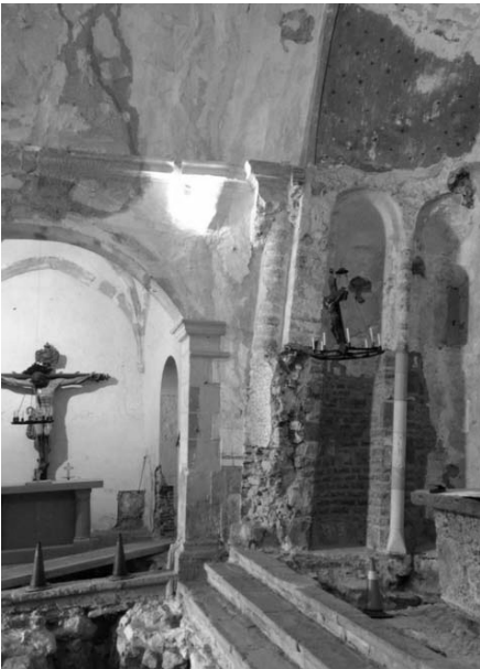
Imagen en que se aprecia el vuelco del ábside respecto al acceso a la capilla norte.
