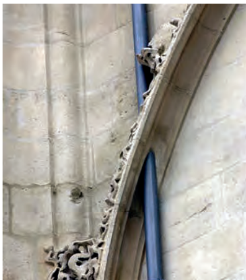
9. Detalle de la destrucción de molduras para pasar el cañal (imagen de la autora).
