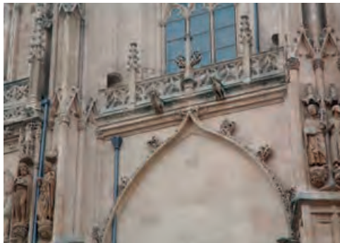
8. Lamentable aspecto de las bajantes de los canalones que han sustituido a las gárgolas (imagen de la autora).
