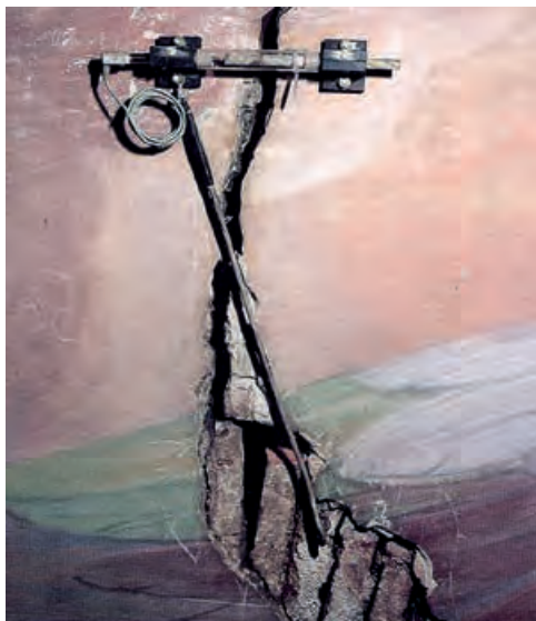
6. Un deformometro posto in corrispondenza di una lesione (foto Soprintendenza per i Beni A. e A di Firenze).
