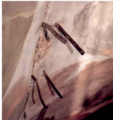
15. Le staffe metalliche rinvenute in corrispondenza degli otto spigoli interni della cupola. Esse erano destinate a sorreggere le centine lignee atte a delineare progressivamente l'arco di circonferenza.
