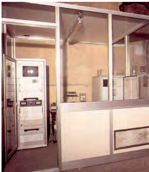
5. La centralina di raccolta dei dati del sistema automatico di monitoraggio strutturale della cupola, installata in una delle 'tribune morte' (foto dell'autore).
