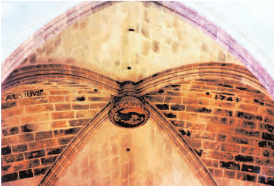
Inscripción sobre la bóveda de la Catedral de Mallorca reparada en 1743. Foto: José Luis González Moreno-Navarro
