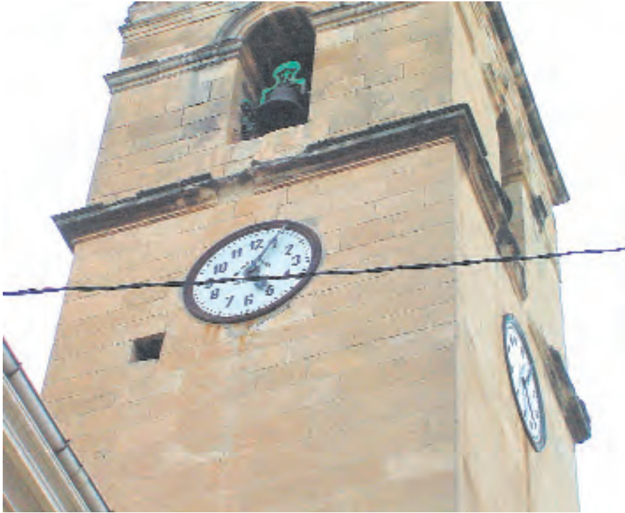
Estado de las cornisas del campanario de la torre antes de la intervención en 2003. Foto: Miguel Louis Cereceda
