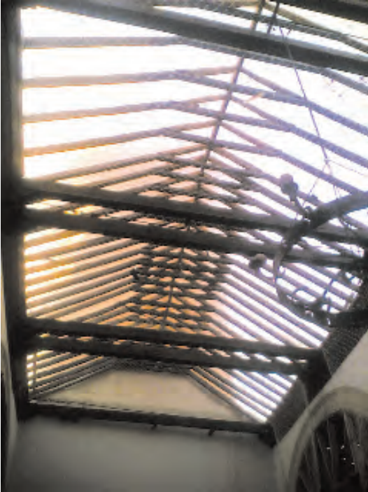
Parroquia de Malaguilla. Daños estructurales observados. Foto: Material del estudio
