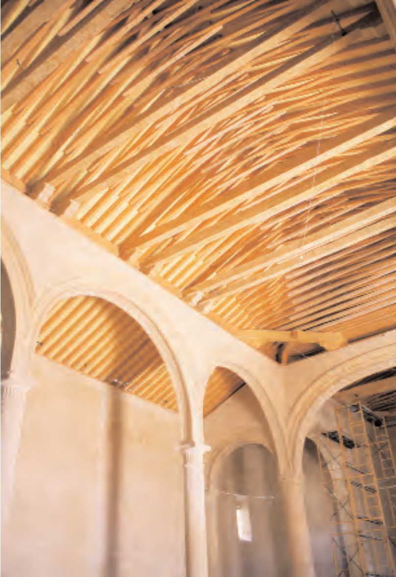
Nuevo artesanado de madera como estructura de soporte de la cubierta de la iglesia de Valdetorres de Jarama en Madrid. Foto: Latorre y Cámara arquitectos
