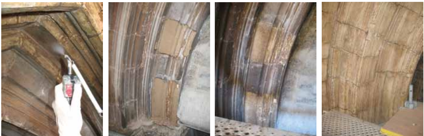
Fig. 6,7,8 i 9. Procés de neteja de l'intradós de l'arc del portal lateral dret mitjançant apòsits. Fig. 6,7,8 i 9. Proceso de limpieza del intradós del arco del portal lateral derecho mediante apòsits
