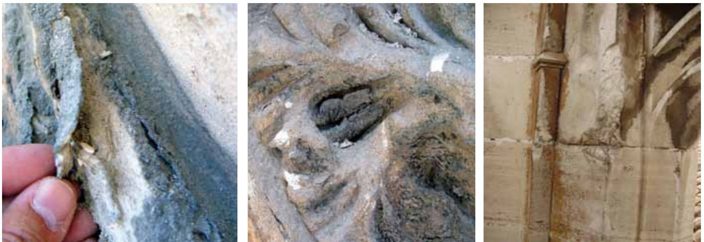
Fig. 22. Despreniment de crosta d'antiga consolidació. Fig. 23. Detall de crostes, exfoliadures, esquerdes, pulverulències, etc. Fig. 24. Restes de pàtina. Fig. 22. Desprendimiento de costra de antigua consolidación. Fig. 23. Detalle de costras, exfoliaduras, grietas, pulverulencia, etc. Fig. 24. Restos de pátina
