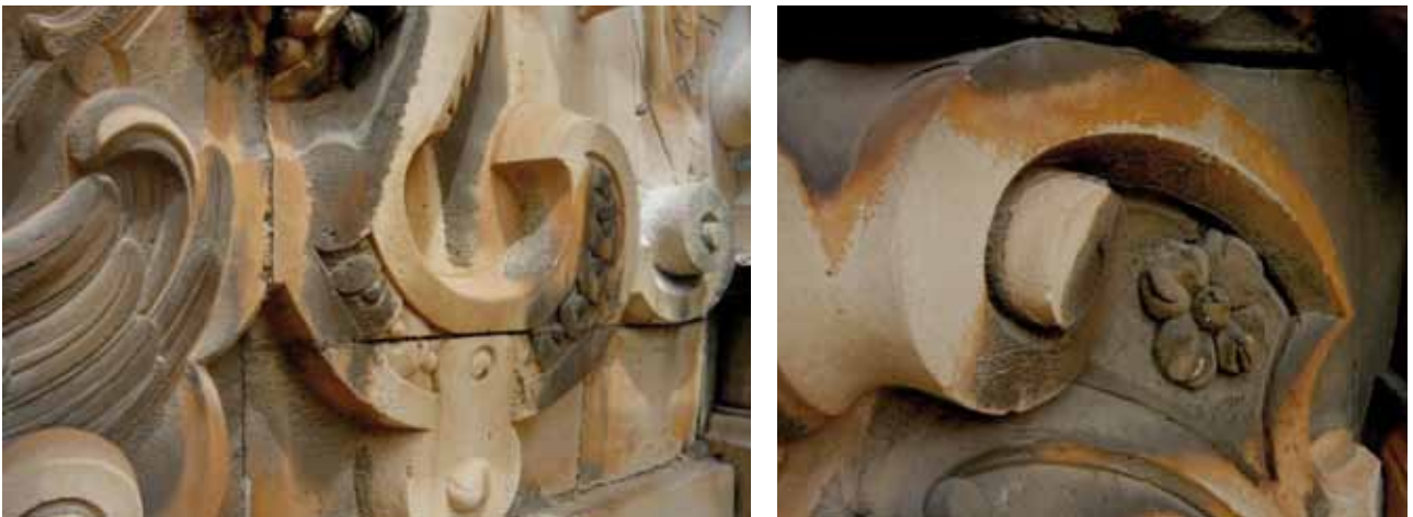
Fig. 11. Detall de crosta de contaminació als relleus i pèrdues de juntes. Fig. 12. Crosta de contaminació i capa pictòrica. Fig. 11. Detalle de costra de contaminación en relieves y pérdidas de juntas. Fig. 12. Crosta de contaminación y capa pictòrica
