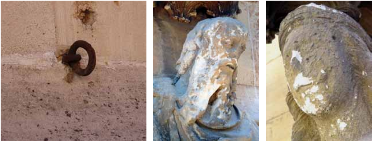
Fig. 16. Ferro incrustat al parament. Fig. 17. Pèrdua de la superfície externa de la pedra. Fig. 18. Rostre de santa Catalina, totalment deteriorat. Fig. 16. Hierro incrustado en el paramento. Fig. 17. Pérdida de la superficie externa de la piedra. Fig. 18. Rostro de Sta. Catalina totalmente deteriorado
