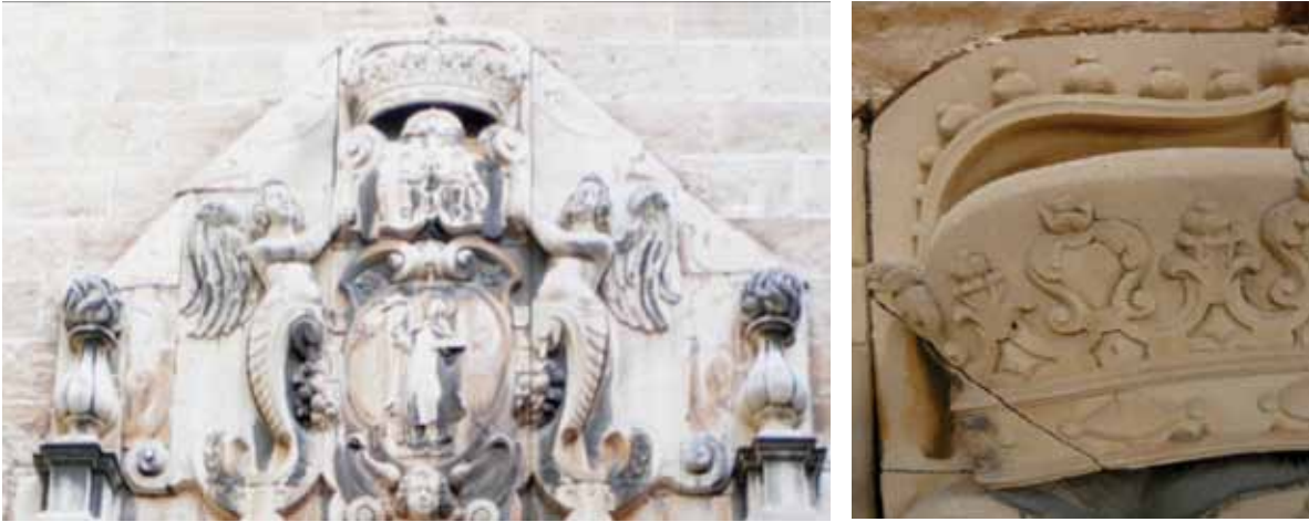
Fig. 1. Vista de la portada abans del procés. Fig. 2. Fissura a la corona. Fig. 1. Vista de la portada antes del proceso. Fig. 2. Fisura en la corona
