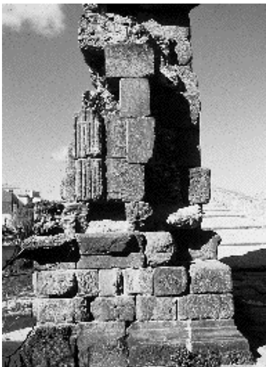
Pilar del arco romano del puente del Diablo, Castellbisbal (Vallès Occidental, Barcelona), después de la consolidación dirigida por Jeroni Martorell en 1927. Foto: A. González, 25.03.1986.
