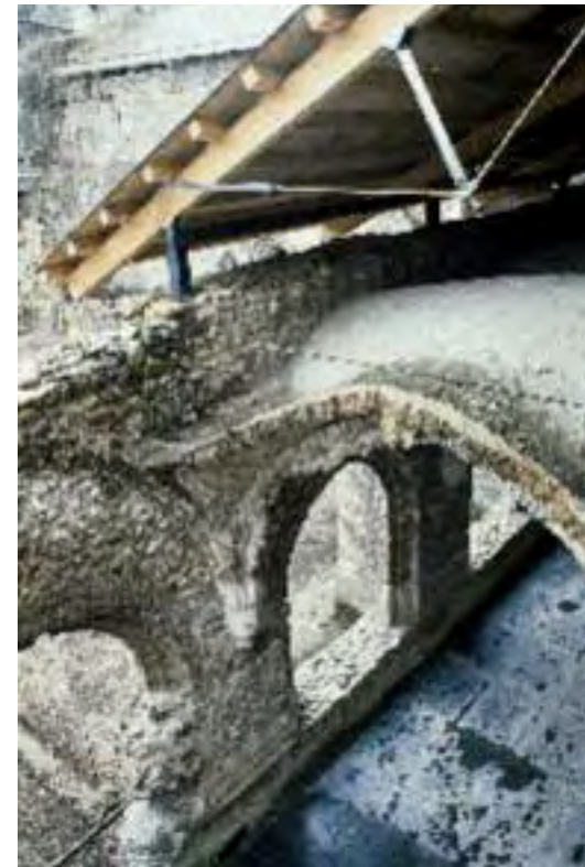
Monasterio de San Salvador de Carracedo, Cacabelos (León), una restauración conceptual y formalmente del máximo interés, pero dudosamente «reversible», tal como se pretendió, según parece desprenderse de los planteamientos teóricos de sus autores (arquitectos, Salvador Pérez Arroyo y Susana Mora Alonso-Muñoyerro, 1988-1991). Foto: A. González, 21.01.1990.
