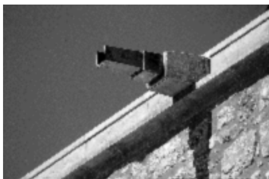
Iglesia de Santa Cándia, Orpí (Anoia, Barcelona). Estudio After Ten y restauración posterior (arquitecto, A. González, 1997). Portada: análisis del estado de los elementos originales y los aportados en la restauración de 1985. Cubierta: comprobación del estado de conservación de las telas butílicas empleadas en 1985. Reforma y mejora de la gárgola de 1985, para evitar los defectos de evacuación de aguas constatados. Fotos: M. Baldomà, 31.01.1997 y 03.1997.
