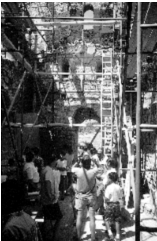
Visita de los vecinos de la urbanización que rodea la iglesia de Sant Jaume Sesoliveres, Igualada (Anoia, Barcelona), para recibir explicaciones sobre el curso de las obras y el proyecto por ejecutar. Foto: A. González, 27.07.1994.
