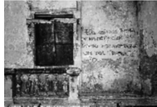
«Esta es una forma de menospreciar el Pasado y de avergonzarnos del Presente», grafito en un edificio abandonado con suficientes valores para ser conservado. Valencia de Carabobo (Venezuela). Foto: A. González, 08.10.1991.
