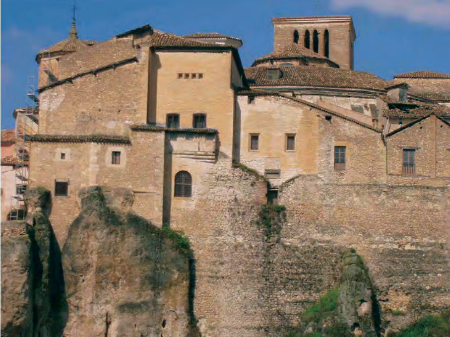
Fachada de la Catedral de Cuenca que mira al río Huécar antes del proceso de restauración. Fuente: Proyecto de restauración y rehabilitación de la Catedral de Cuenca
