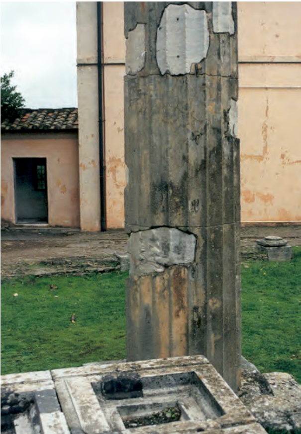
Detalle de uno de los fustes de las columnas del templo de Venus Cnidia en Villa Adriana, con la actuación de anastilosis mediante el empleo de cemento Pórtland en fase de sustitución. Foto: Isabel Bestué Cardiel
