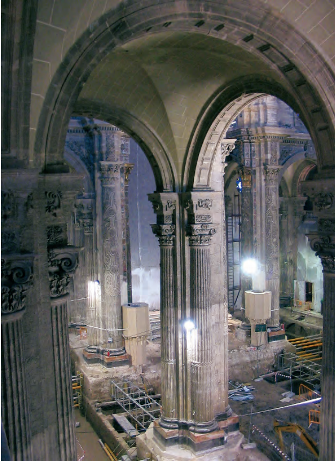
Obra en el interior, 17 de mayo de 2004. Foto: Estudio Fernando Mendoza Castells
