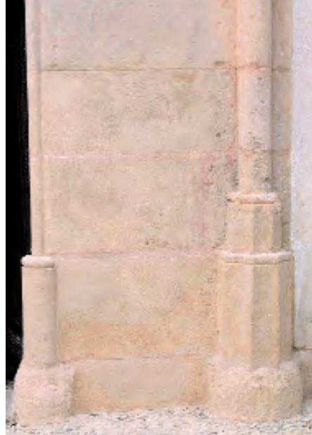
Intervención de restauración realizada con mortero de cal llevada a cabo en la Portada del Convento de la Concepción (Granada). Foto: Ana Luque
