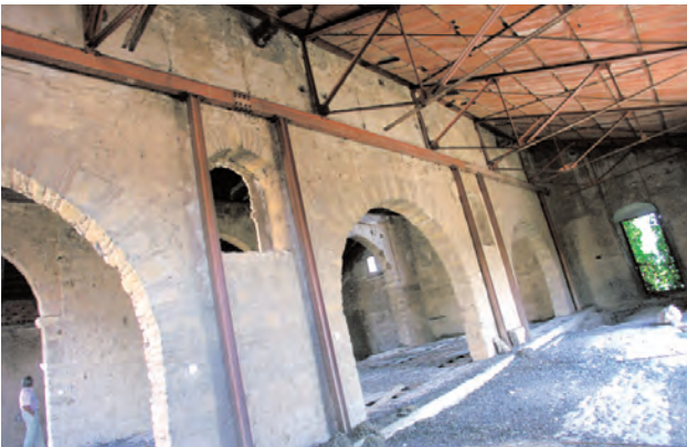
Antigua consolidación estructural de la cubierta de la iglesia del convento de Santa Clara en Córdoba mediante la superposición de una estructura de acero apoyada en zunchos y forjados de hormigón. Foto: Pablo Latorre González-Moro
