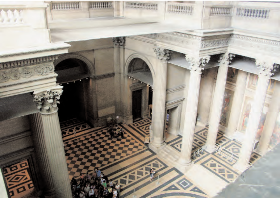
En la actualidad en la Iglesia de Santa Genoveva de Paris se han reparado los desperfectos anteriores pero no se ha podido detener el proceso de rotura de la piedra lo cual obliga a limitar la zona visitable y proteger ésta con redes. Foto: José Luis González Moreno-Navarro
