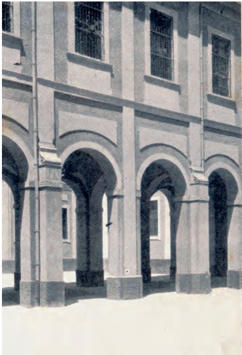
Estado de la estructura cruciforme de Talavera tras la supresión de dos alas por parte de Basterra. Fuente: C.E.A. El Palacio de San Telmo, en Sevilla. Arquitectura , 119, marzo, 1929
