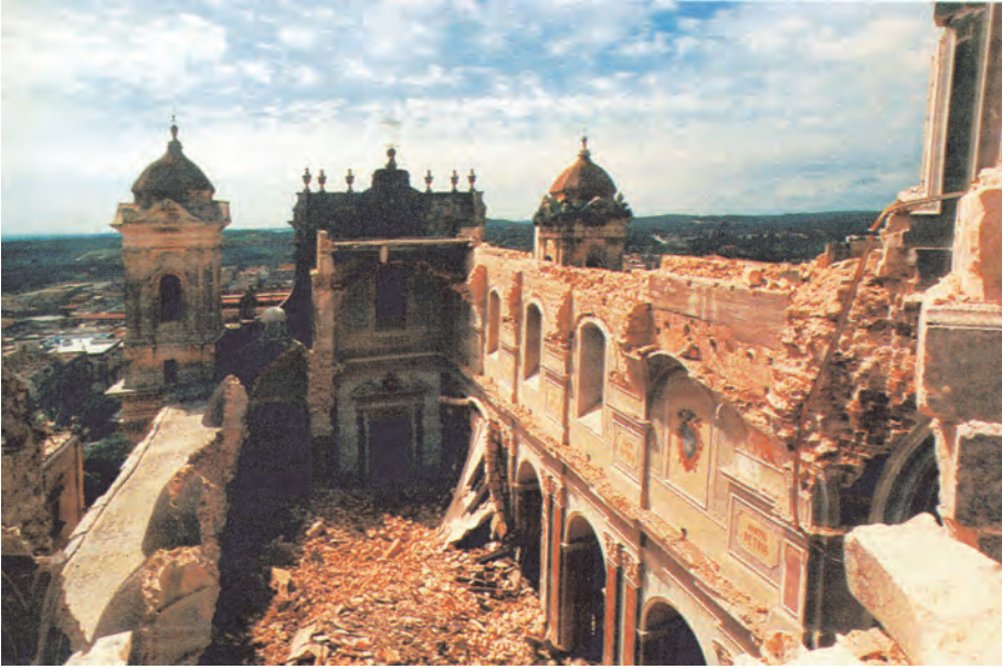
En la Catedral de Noto, el colapso de un pilar afectó a toda la nave y parte de la cúpula debido al efecto de arrastre que ocasionó un "veintestigero" forjado de hormigón armado soporte de una siglo "veintestigera" cubierta plana. Fuente: DE BENEDICTIS, ROBERTO, TRINGALI, SALVATORE: LaRiconstruzione della Cattedrale di Noto, Noto: L.C.T. Edizioni, 2000
