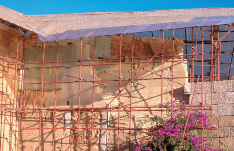
Murallas de Capo Soprano (Gela, Sicilia). La des-restauración (noviembre 2006) y restos de las láminas colocadas por Minissi en 1954. Foto: Claudio Varagnoli
