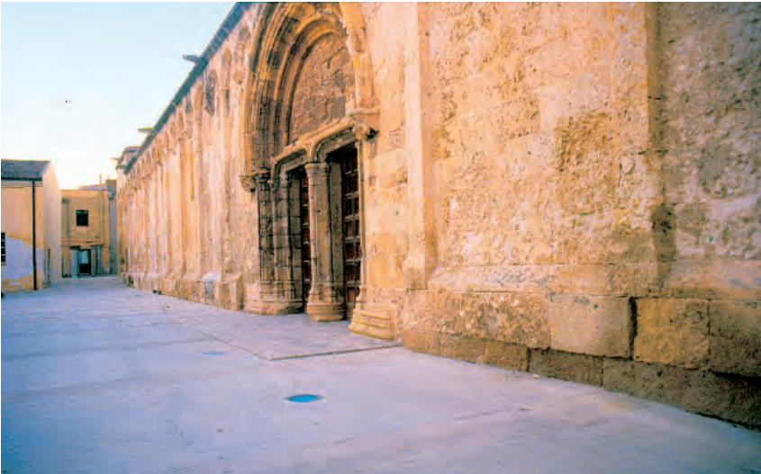
San Gavino en Porto Torres después de la restauración de 2006, con la eliminación de los escalones añadidos por Vico Mossa. Foto: Stefano Gizzi
