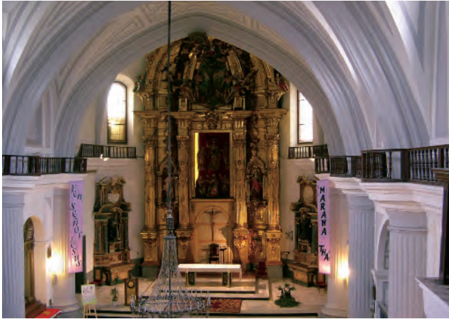
Arcos-diafragma del interior de la iglesia de 13 m de luz libre. Foto: Eduardo Miguel González Fraile
