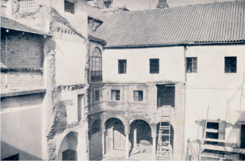
Derribo de patios barrocos durante la ejecución de las obras de 1926-28. Fuente: C.E.A. El Palacio de San Telmo, en Sevilla. Arquitectura , 119, marzo, 1929
