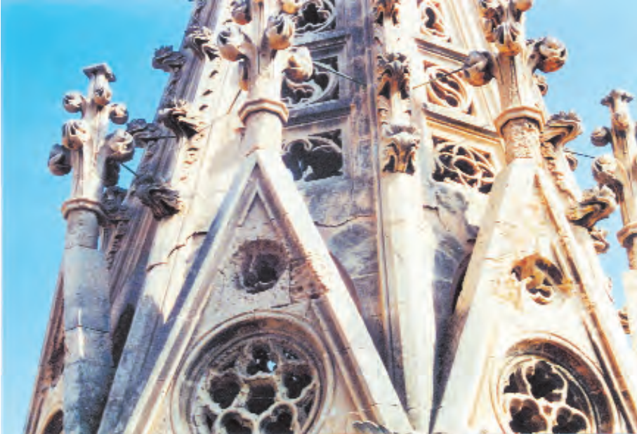
Rotura de los sillares por oxidación de un cable-zuncho interior en uno de los pináculos decimonónicos de la Catedral de Mallorca. Foto: José Luis González Moreno-Navarro
