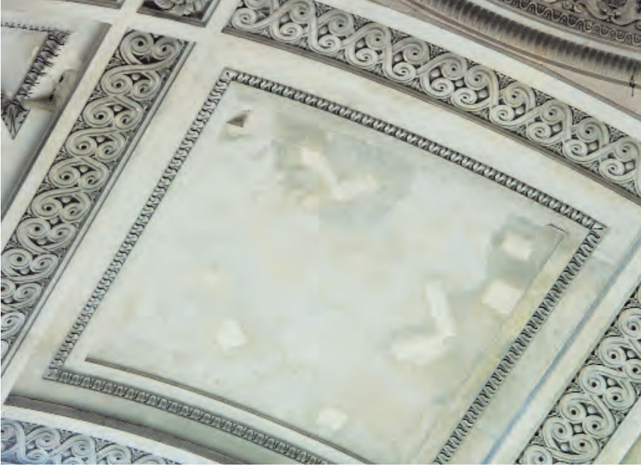
Desperfectos graves debidos a la oxidación de las armaduras que sostienen los sillares y dovelas en el interior de de la Iglesia de Santa Genoveva de Paris. Foto: Jose Luis González Moreno-Navarro
