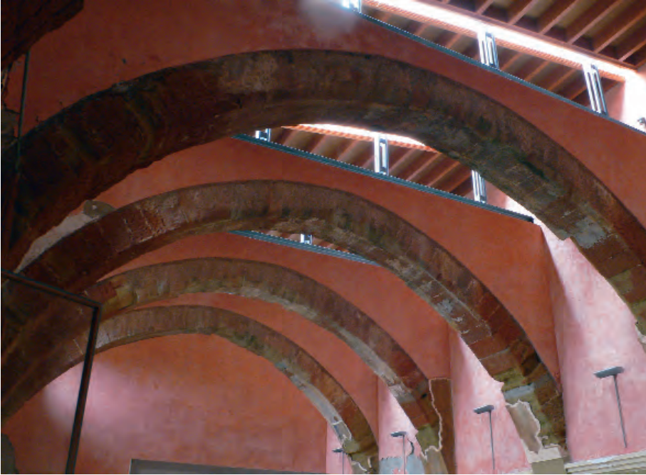
Restauración de la sala capitular. Emilio Rivas, 1989-1991. Foto: Luis Franco y Mariano Pemán
