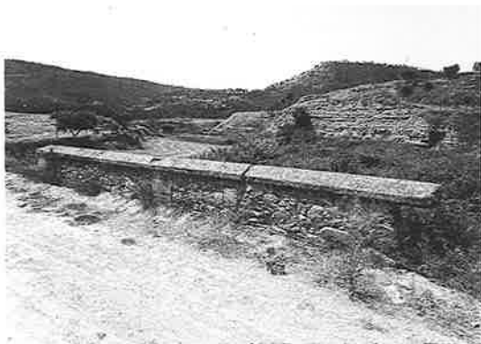
Estat que presentava l'ampit del pont abans de la restauració. Foto: Joan Francés. SPAL, 24.7.1984. A la dreta, detall del nou paviment de la calçada del pont. Foto: Jordi Isern. SPAL, 8.3.1993.
