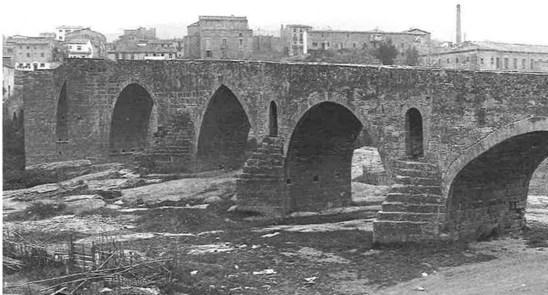
El pont vist des d'aigües amunt, abans de la restauració iniciada el 1989. Foto: SPAL, 3.4.1968.
