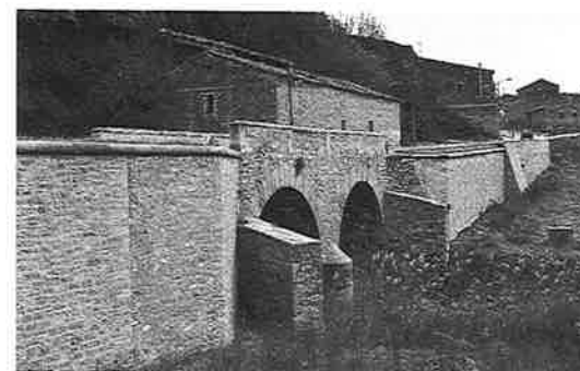
Façana del pont aigües avall després de la restauració. Foto: Jordi Isern, SPAL, 8.3.1993.
