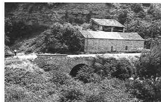
Façana del pont aigües avall, abans de les obres de restauració. Foto: Joan Francés, SPAL, 24.7.1984.
