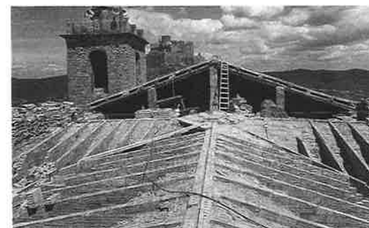
Panoràmica de la coberta en el curs de les obres. Foto: Joan Francés. SPAL, 13.5.1985. A la dreta, construcció de la nova coberta de la nau. En primer terme, la cobertura d'una clau de volta. Foto: Joan Francés. SPAL, 4.7.1985.
