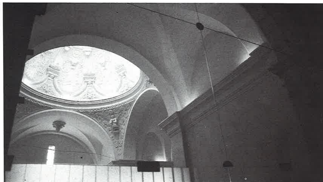
Vista de la cúpula del creuer des de l'exterior de la capella. Foto: M. Baldomà. SPAL, 27.11.1991.
