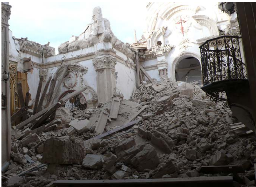
Figura 50. Destrucción de la iglesia de Santiago de Lorca después del terremoto de 2011. Fotografía: Concha Cirujano.
